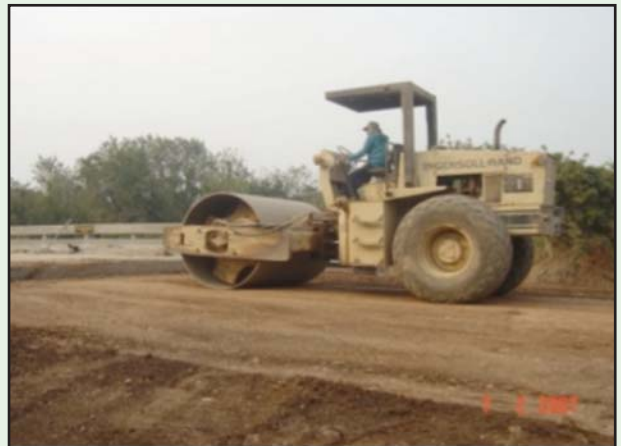
รูปที่ 4-23 การบดอัดบริเวณที่อยู่ใกล้กับโครงสร้าง คสล. ไม่ควรสันสะเทือนเนื่องจากจะทำให้โครงสร้างเสียหายได้
