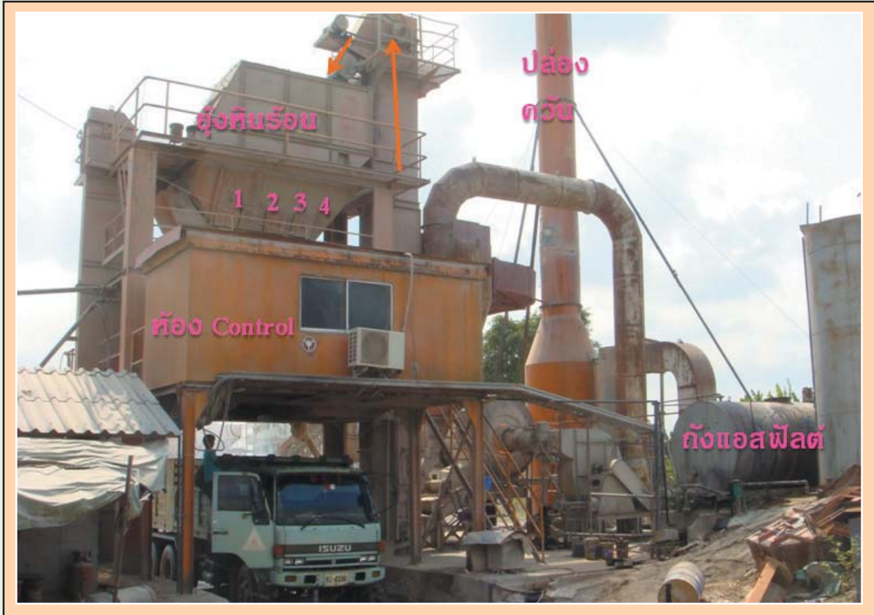
รูปที่ 6-19 อุปกรณ์ต่างๆ ของโรงผสมแอสฟัลต์คอนกรีต
