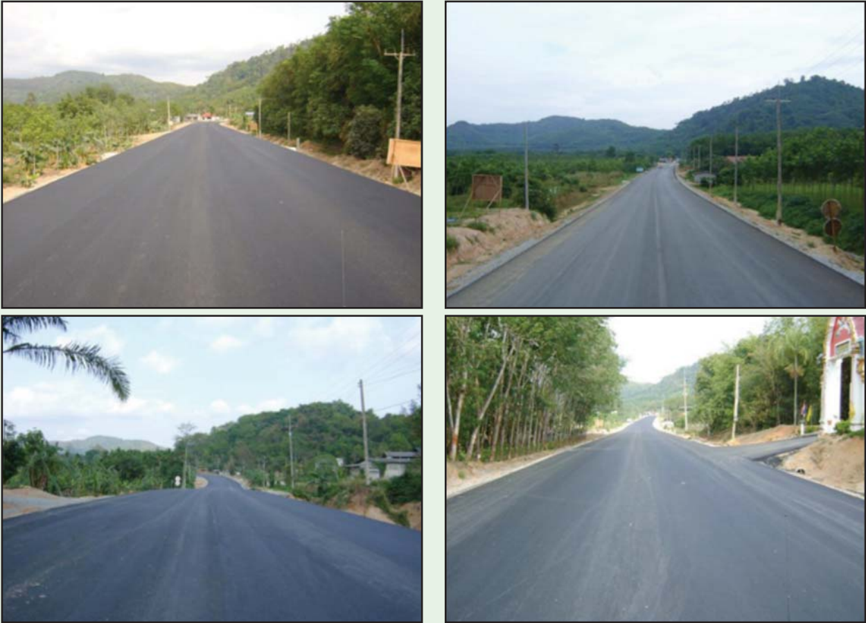
รูปที่ 6-39 ผิวทางที่ก่อสร้างแล้วเสร็จ จะต้องเรียบได้ระดับและรูปแบบ
