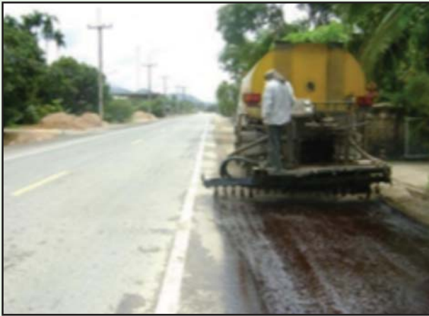
รูปที่ 6-5 เครื่องทำยควบคุมแรงดันยาง
