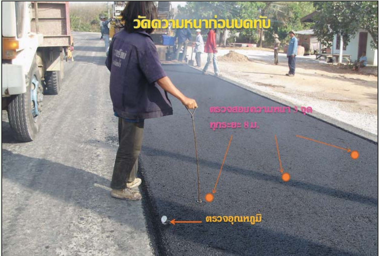
รูปที่ 6-31 การตรวจสอบความหนาและอุณหภูมิขณะปูแอสฟัลต์คอนกรีต
