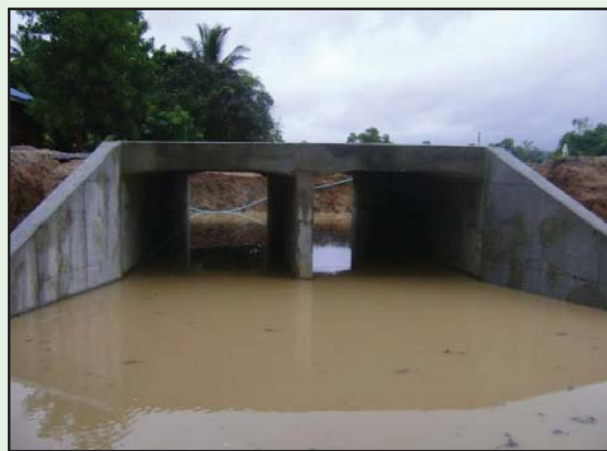
รูปที่ 5-17 ลักษณะท่อเหลี่ยมที่ก่อสร้างแล้วเสร็จ
