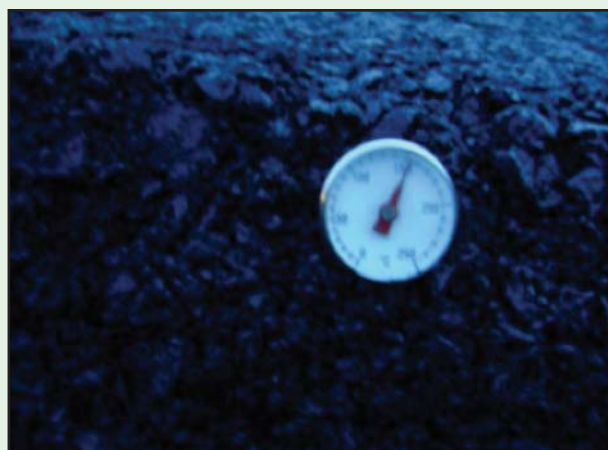
รูปที่ 6-28 ตรวจสอบอุณหภูมิก่อนใช้งานและขณะปูลงบนพื้นทางต้องอยู่ในช่วง 120 - 150^{\circ}\text{C}
